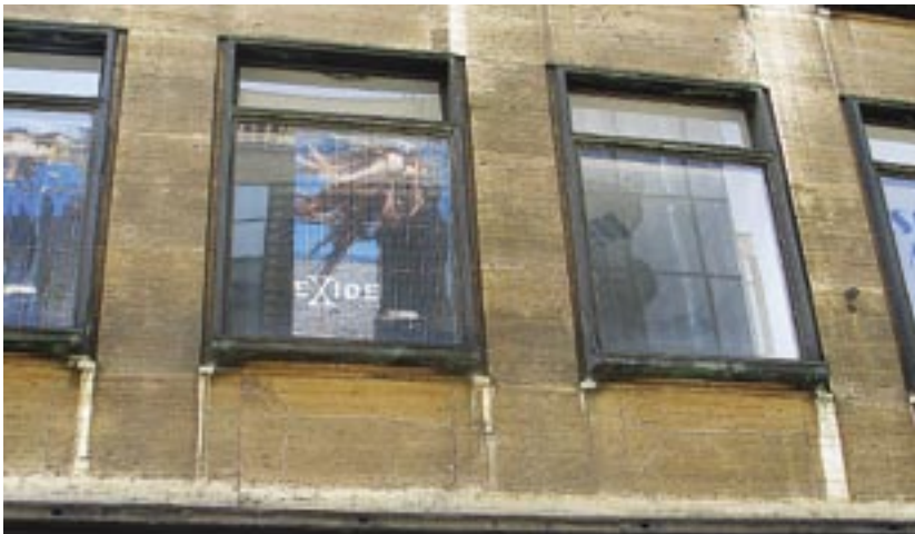
Fot. 11.1 Wpływ kwaśnych deszczy na elewację z trawertynu.
